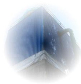
TORRES DE REFRIGERACION
