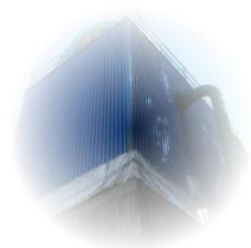
Torres de refrigeración
